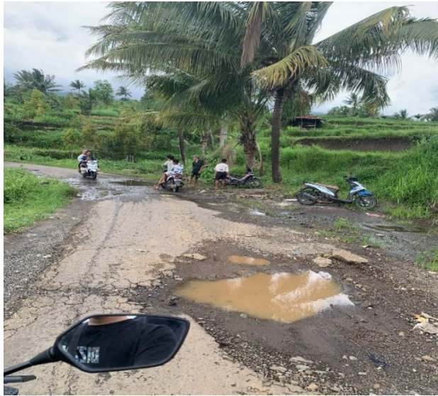
Gambar 1.1 Kerusakan jalan (Sumber: Dokumentasi pribadi, 2024)
