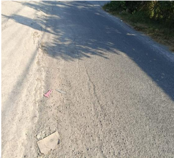
Lampiran 6. Retak Memanjang Sta 1+1000 – 1+200
