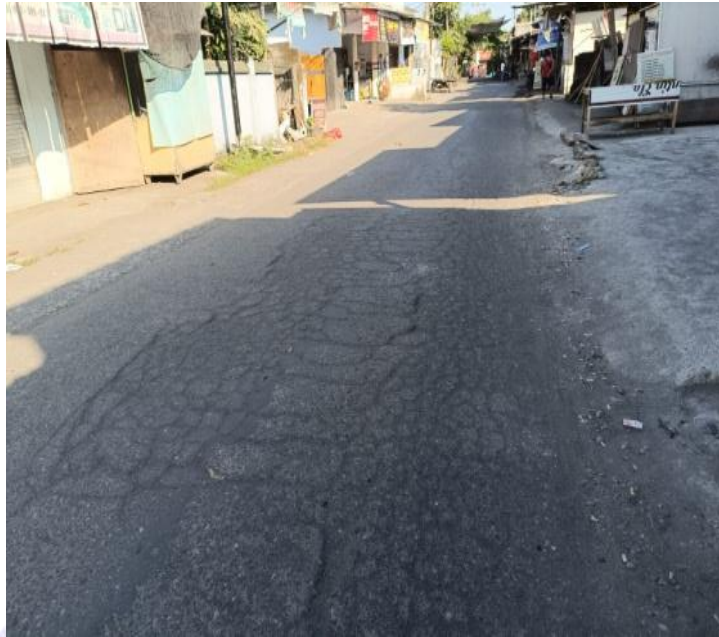
Lampiran 8. Retak Kulit Buaya Sta 0+800 – 1+000
