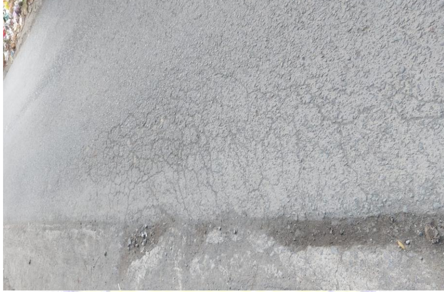
Gambar pengambilan data kerusakan
