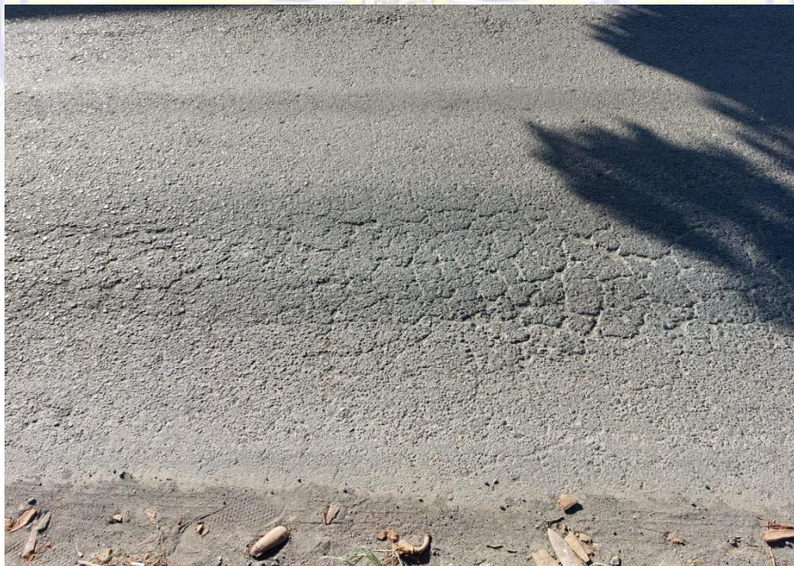
Gambar pengambilan data kerusakan
