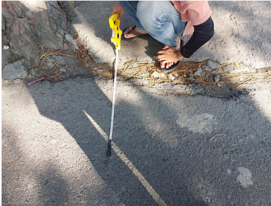
Gambar pengambilan data kerusakan
