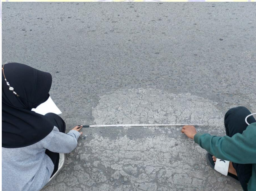
Gambar pengambilan data kerusakan
