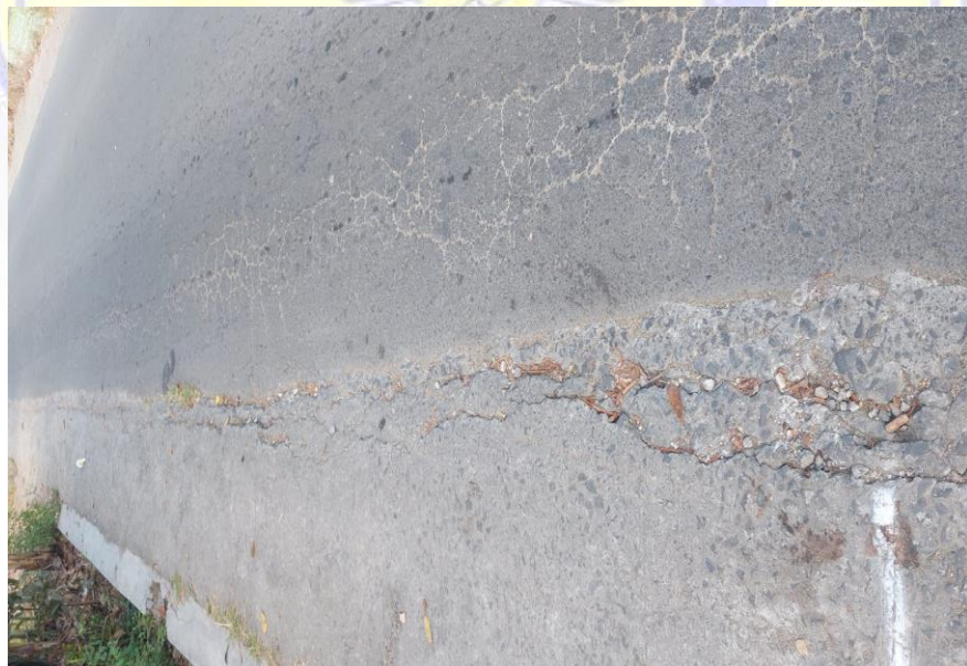
Gambar pengambilan data kerusakan
