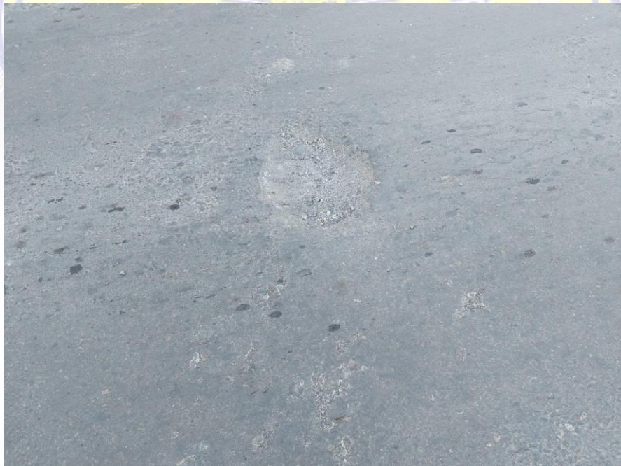
Gambar pengambilan data kerusakan
