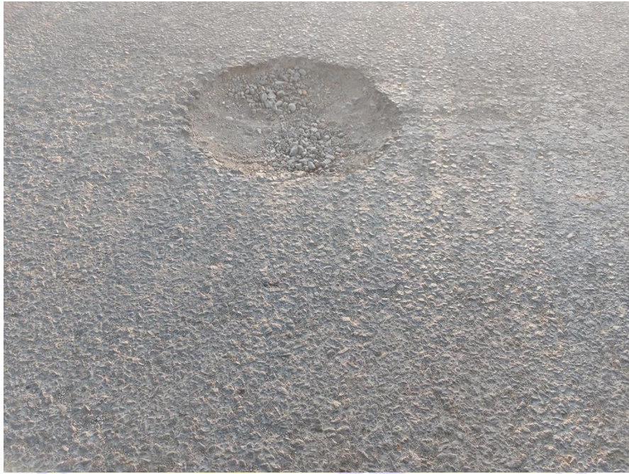
Gambar pengambilan data kerusakan
