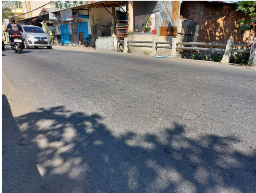
Gambar pengambilan data kerusakan
