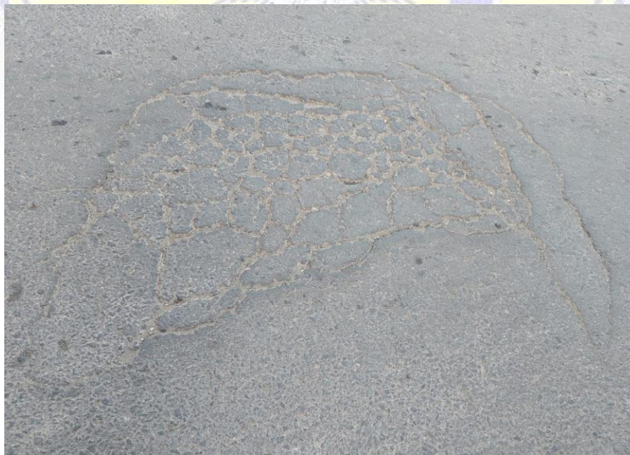
Gambar pengambilan data kerusakan
