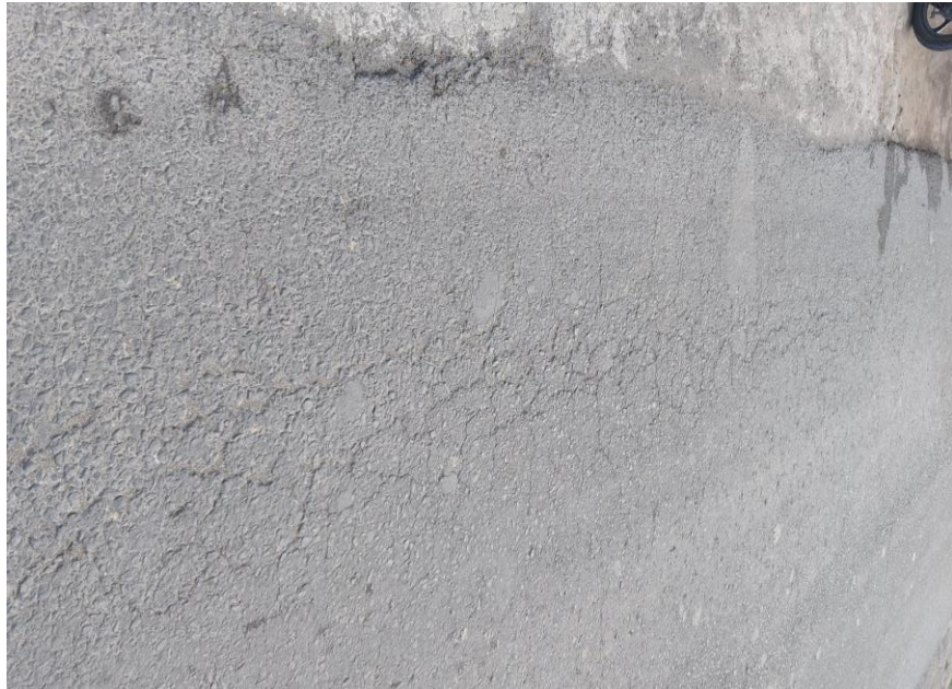
Gambar pengambilan data kerusakan
