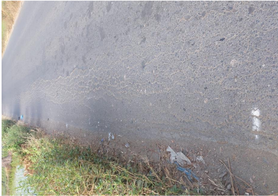
Gambar pengambilan data kerusakan
