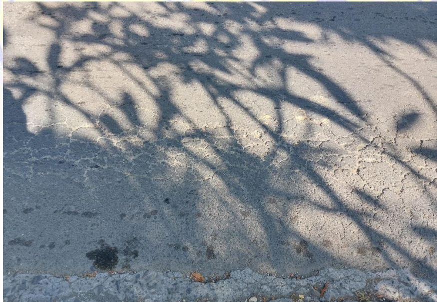
Gambar pengambilan data kerusakan
