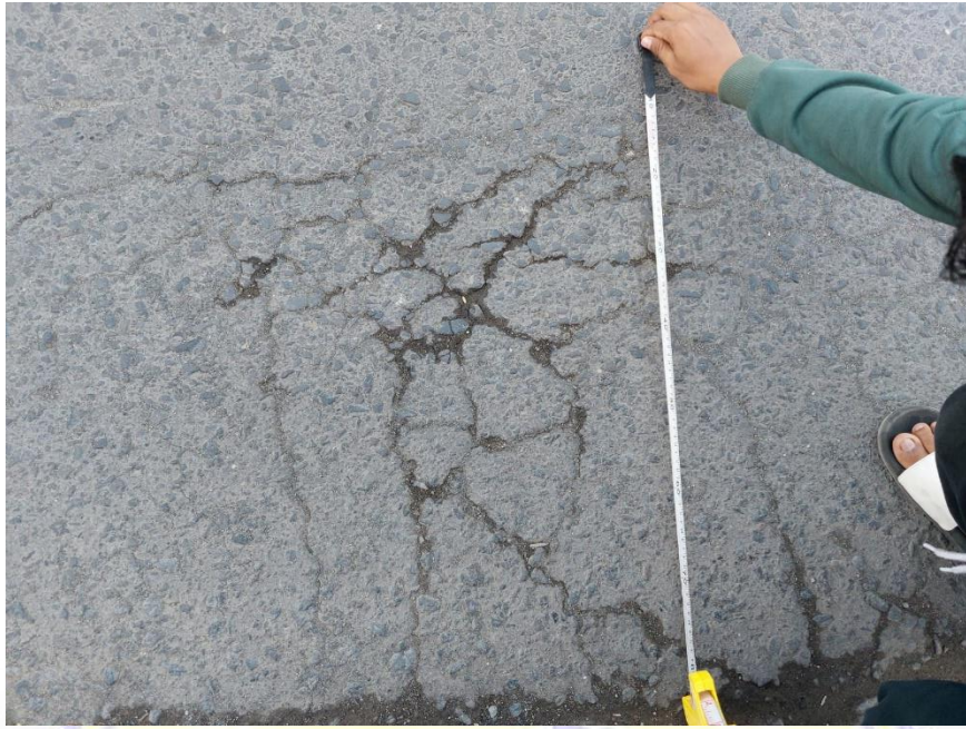
Gambar pengambilan data kerusakan
