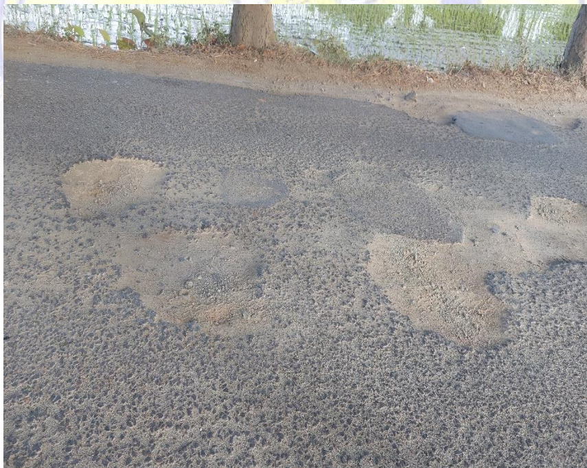
Gambar pengambilan data kerusakan
