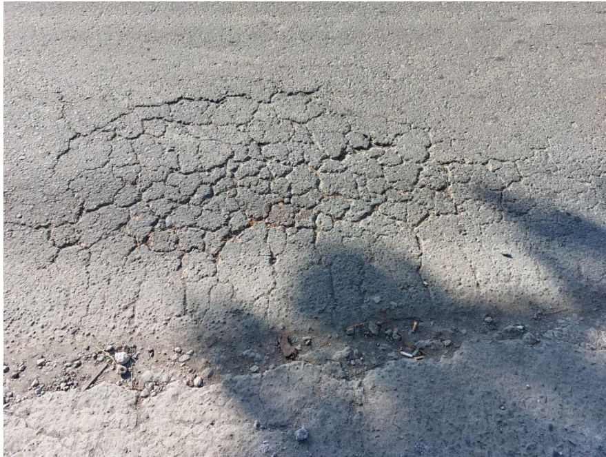
Gambar pengambilan data kerusakan
