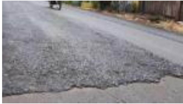
Gambar 2.36. Tambalan dan Galian Utilitas.
