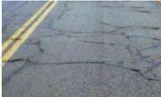
Gambar 2.12. Retak Kotak ( Block Cracking ).
