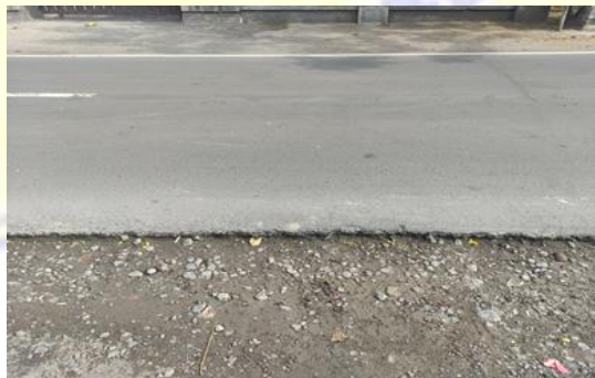
Gambar 2.30. Penurunan Pada Bahu Jalan.
