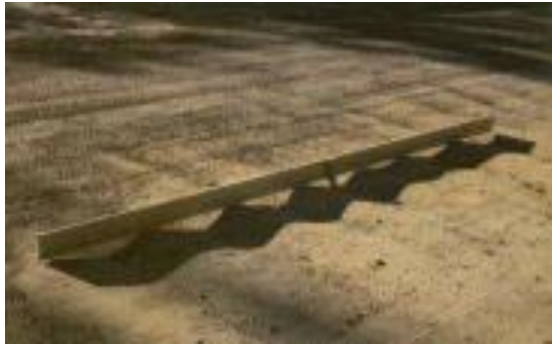
Gambar 2.16. Retak Keriting ( Corrugation ).
