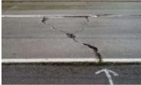
Gambar 2.10. Retak Sambungan Bahu Perkerasan.
