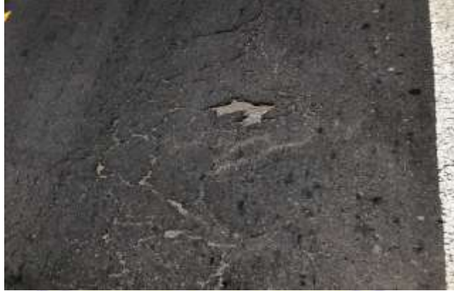
Gambar 2.1 Rusak Retak Kulit Buaya.
