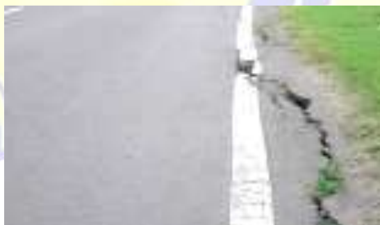
Gambar 2.2 Rusak Retak Memanjang.
