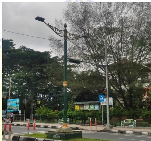
Gambar 2.2 Lampu Penerangan jalan..
