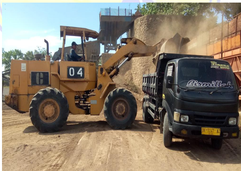
Poto Pekerjaan Tanah di PT.Kresna Karya dengan menggunakan Alat Berat Wheel Loader
