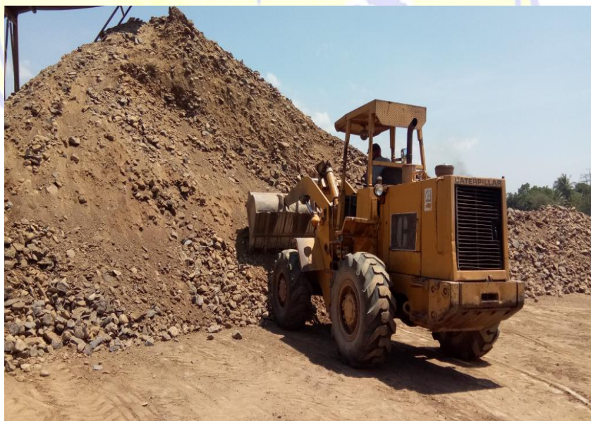
Poto Pekerjaan Tanah di PT.Kresna Karya dengan menggunakan Alat Berat Wheel Loader
