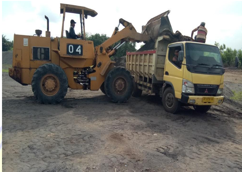
Poto Pekerjaan Tanah di PT.Kresna Karya dengan menggunakan Alat Berat Wheel Loader
