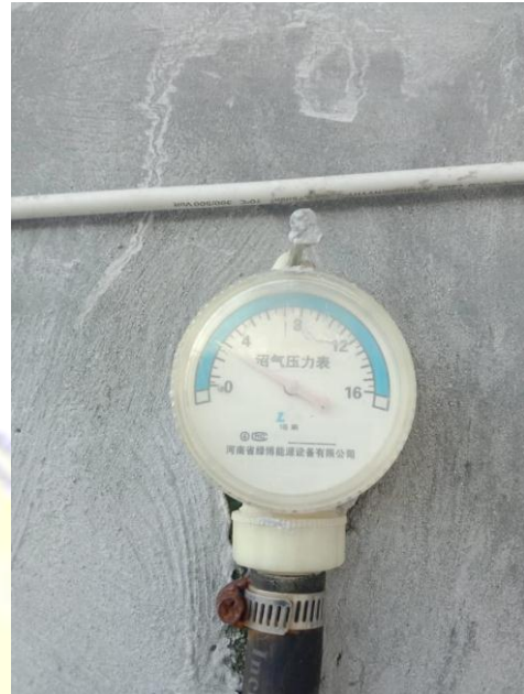
6. Pengecekan nilai tekanan biogas
