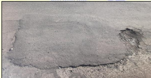
Gambar Kerusakan Tambalan Sta 1+650 – 1+675
