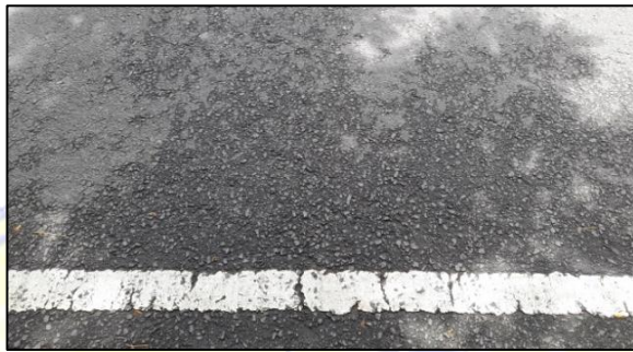
Gambar Kerusakan pelepasan berbutir Sta 0+175 – 0+200
