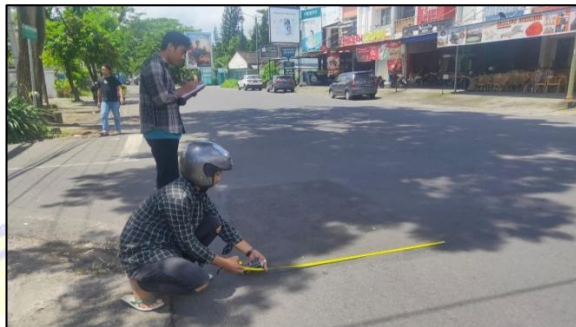
Gambar Pengukuran Luas kerusakan Jalan Sta 0+050 – 0+075
