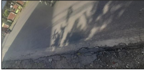
Gambar Kerusakan Retak Pinggir Sta 1+700 – 1+725
