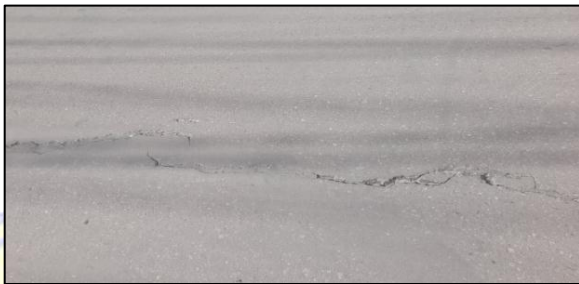
Gambar Kerusakan Retak Memanjang Dan melintang Sta 1+675 – 1+700
