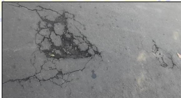
Gambar Kerusakan Berlubang Sta 1+775 – 1+800
