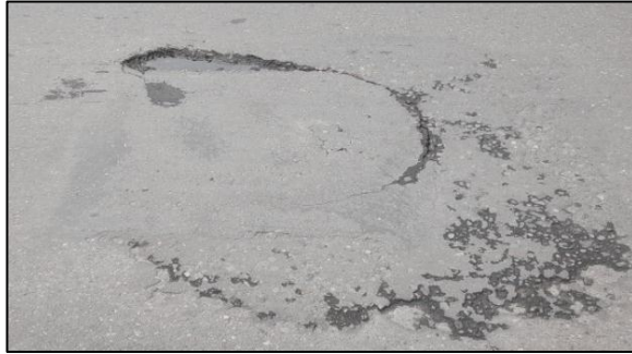
Gambar Kerusakan Amblas Sta 0+150 – 0+175
