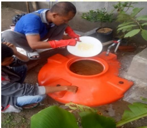
Lem Tutupan Digester Agar Tidak Bocor
