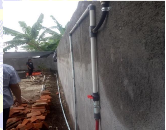
Pipa Sebagai Saluran Gas Murni
