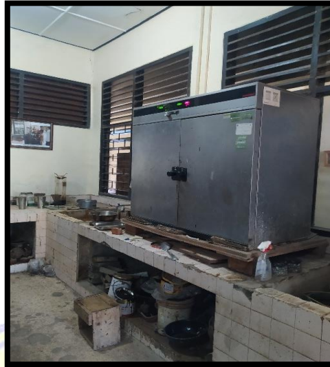
Gambar 3.3 Oven atau pemanas agregat
