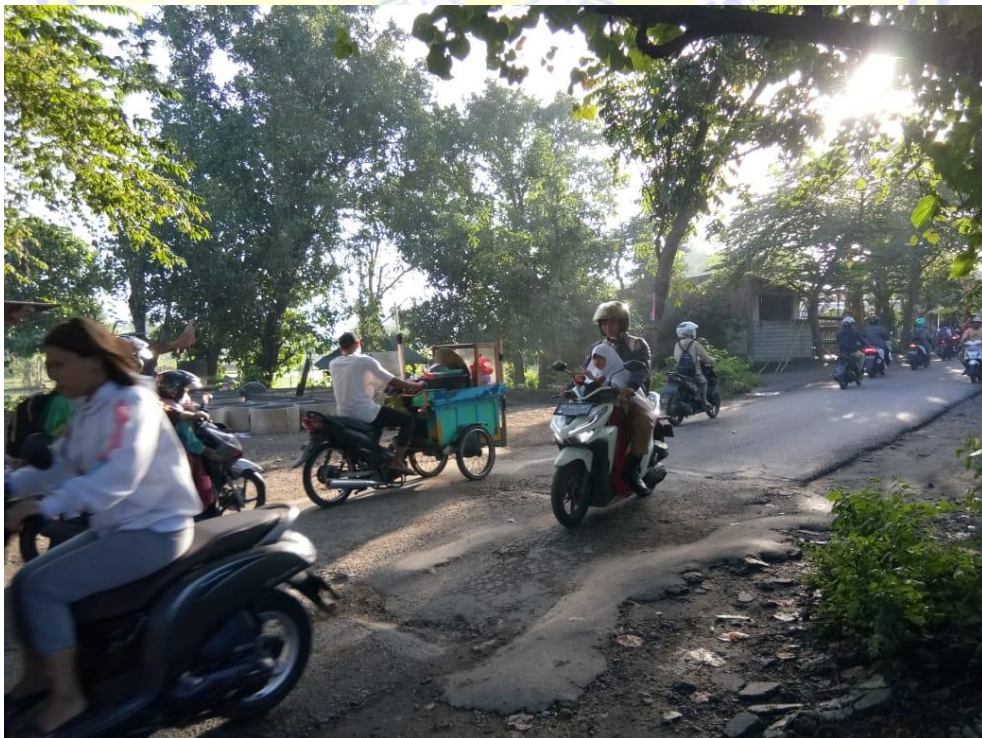
Gambar kerusakan jalan Gunung Pengsong Sta 2+000 – 2+050
