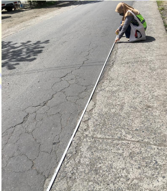
Gambar pengambilam data kerusakan
