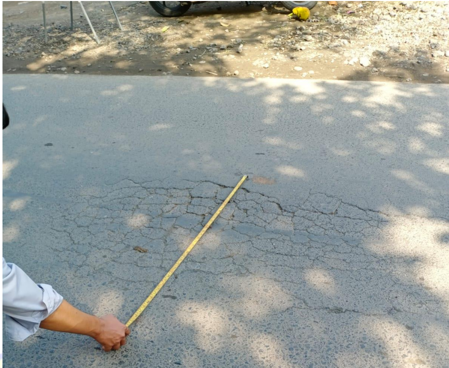
Gambar kerusakan retak buaya Sta 2+200 – 2+250
