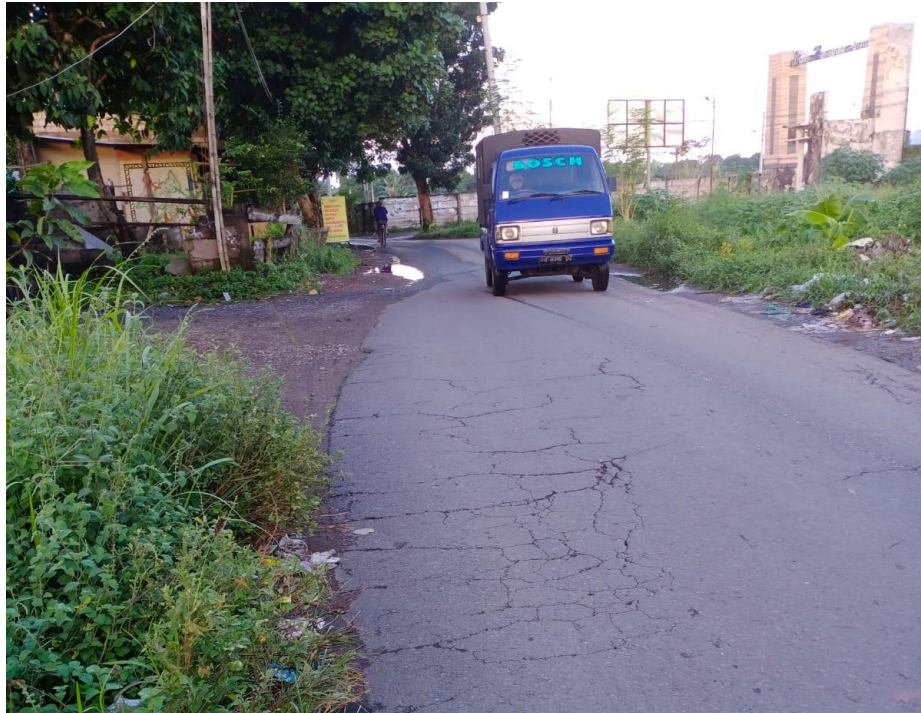
Gambar kerusakan retak kotak Sta 3+100 – 3+150
