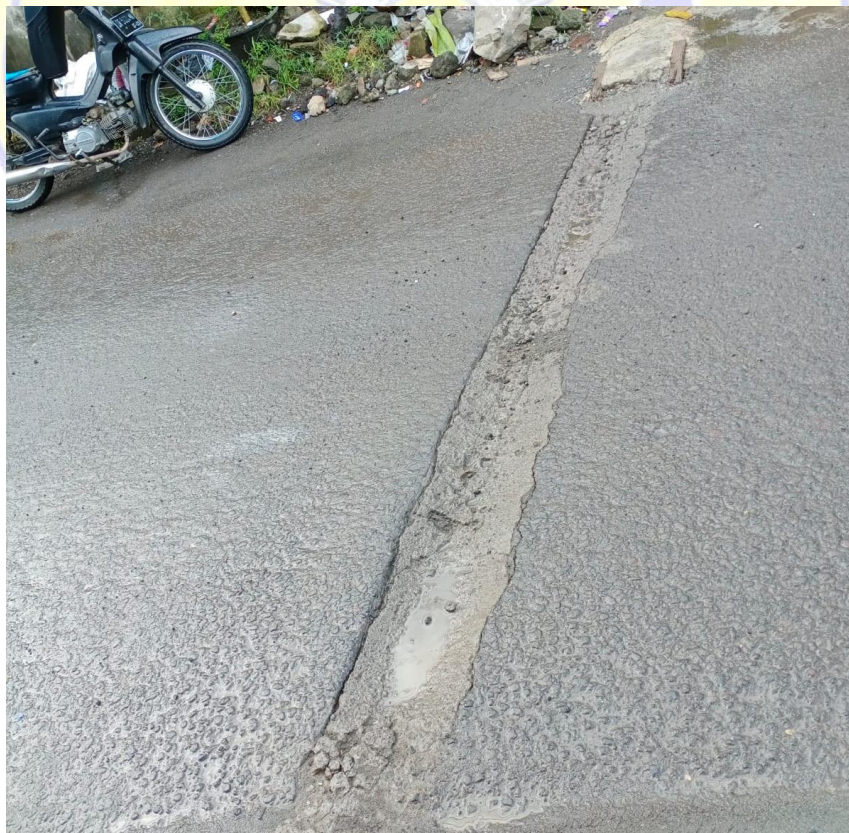
Gambar kerusakan tambalan Sta 3+650 – 3+700
