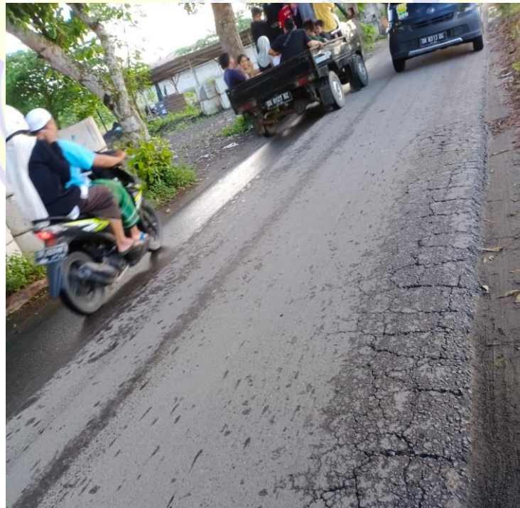
Gambar kerusakan rusak pinggir Sta 2+400 – 2+450
