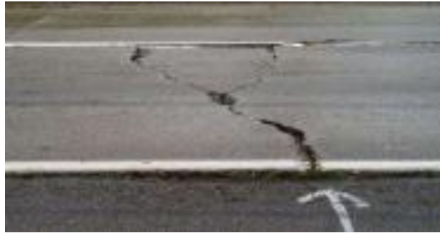
Gambar 2.6 Retak Sambungan Bahu Perkerasan
