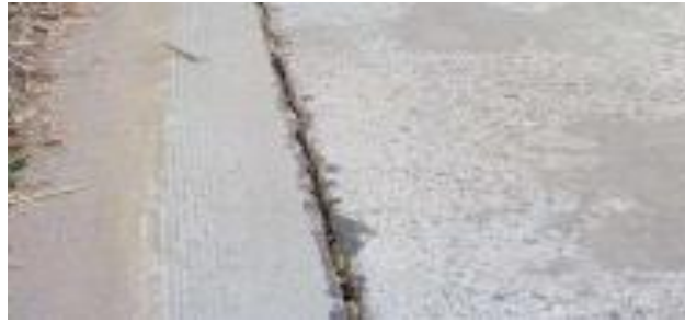
Gambar 2.8 Retak Sambungan Pelebaran Jalan
