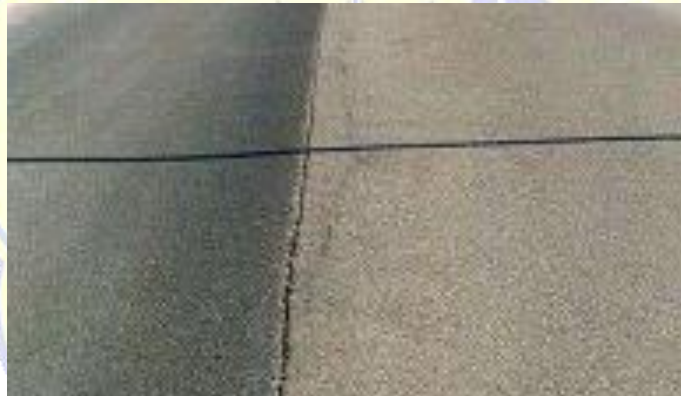
Gambar 2.7 Retak Sambungan Jalan
