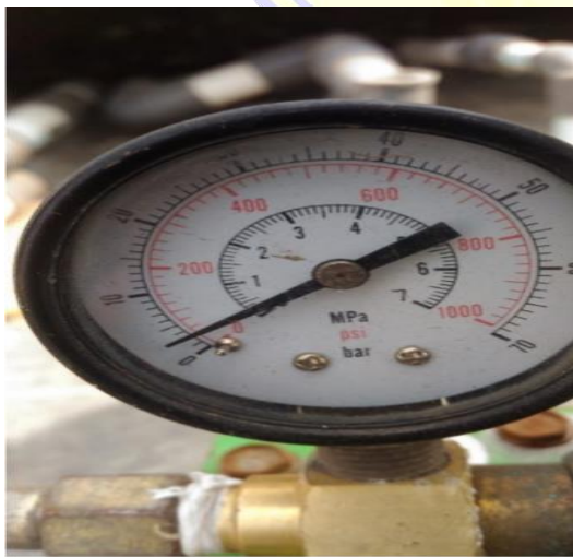
Prossure Gauge Alat Pengukur Tekanan Yang Terpasang Pada Selang
