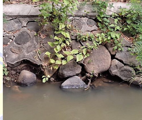
b. Kerusakan Dinding Saluran
