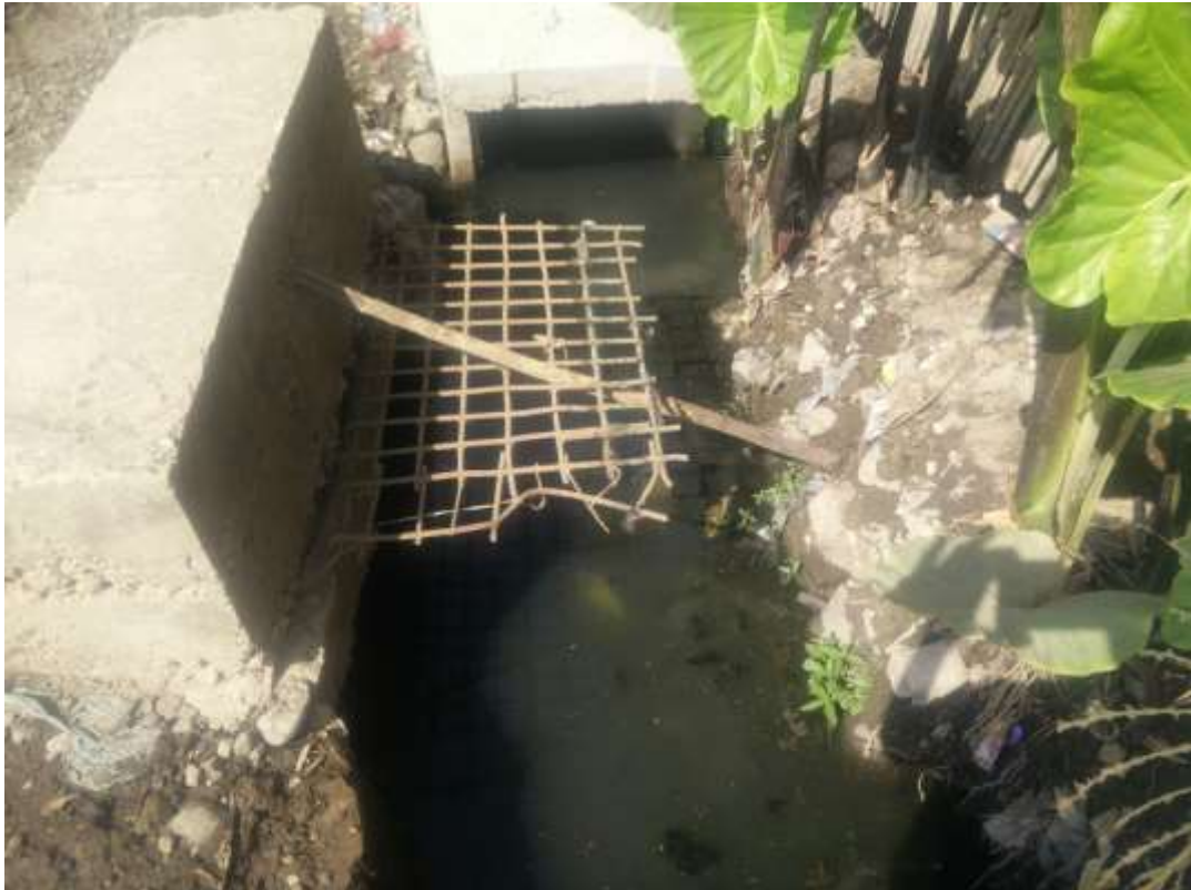
Kondisi drainase di jalan sultan Muhammad salahudin kota bima
