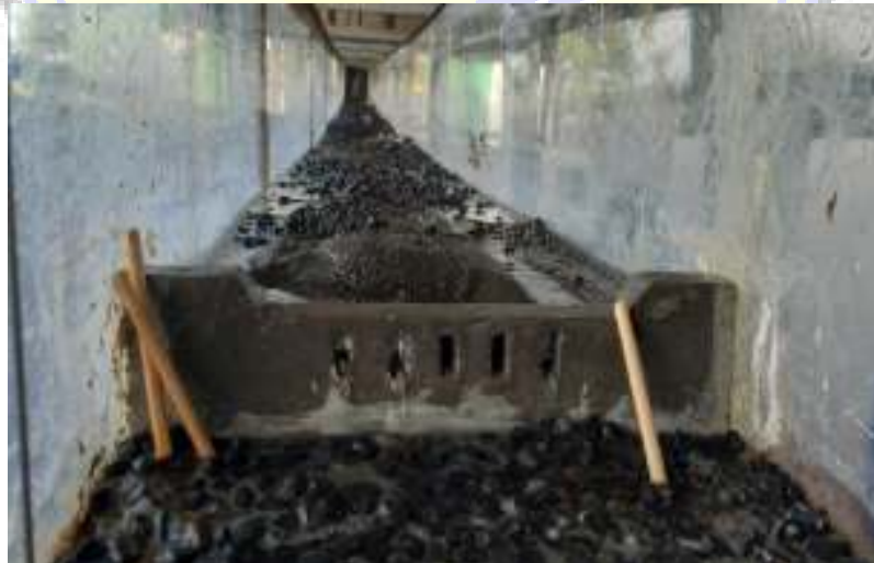
Kayu Tertahan Di Sabo Dam
