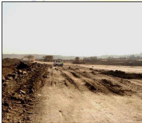
Gambar 4.5 Rutting sebelum perbaikan (Sumber : Penulis, 2023)
