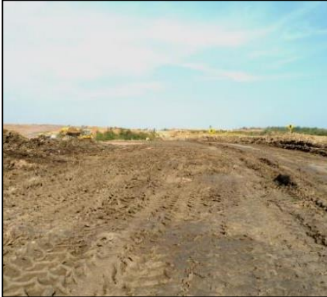
Gambar 4.7 Improper Crosssection sebelum perbaikan (Sumber : Penulis, 2023)
