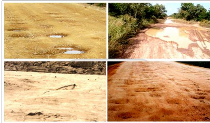
Gambar 2.17 Kerusakan Jalan Berlubang ( Potholes ) (Sumber : Report PT.PAMA, 2015)
