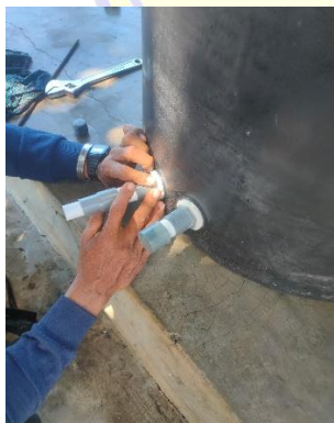
Cek Kebocoran pompa
