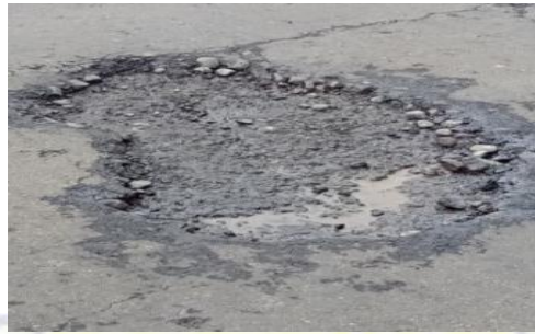
Gambar 2.9 Kerusakan jalan pelepasan butir ( ravelling )
