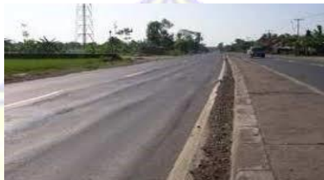
Gambar 2.5 Kerusakan jalan alur ( ruts )
