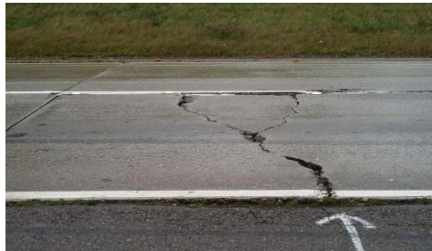
Gambar 2.3 Kerusakan jalan retak sambungan bahu perkerasan
