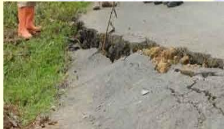
Gambar 2.7 Kerusakan jalan amblas ( grade depressions )
