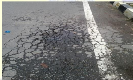
Gambar 2.2 Kerusakan jalan retak kulit buaya
