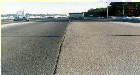
Gambar 2.4 Kerusakan jalan retak sambungan jalan
