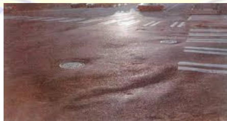
Gambar 2.6 Kerusakan jalan keriting ( corrugation )
