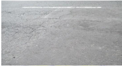
Gambar 2.1 Kerusakan jalan retak halus
