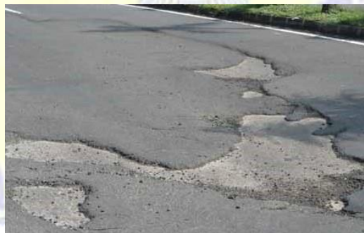
Gambar 2.10 Kerusakan jalan pengelupasan lapisan permukaan
