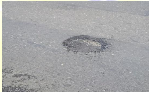
Gambar 2.8 Kerusakan jalan lubang menyerupai mangkuk
