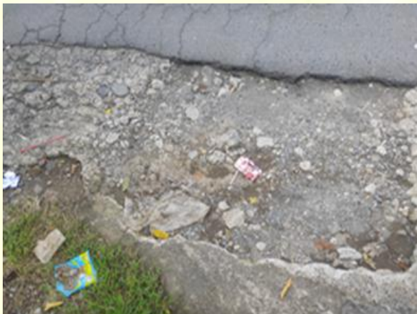
Gambar Kerusakann Pinggir
