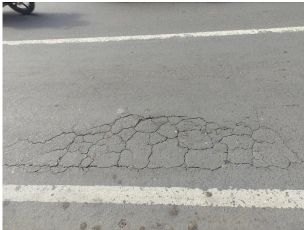
Gambar Kerusakan Retak Kulit Buaya
