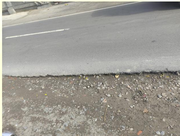
Gambar Penurunan Bahu Jalan
