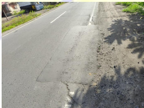
Gambar Kerusakan Tambalan
