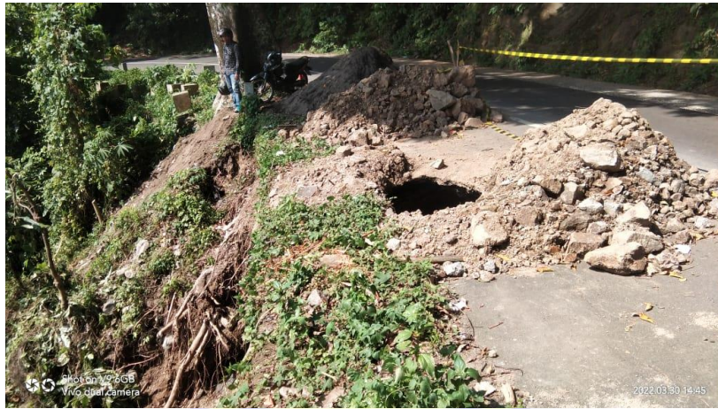
Gambar 1.1 Keruntuhan Tanah Jalan Pemenang (Sumber : Lokasi Pengujian Daerah Pemenang)
